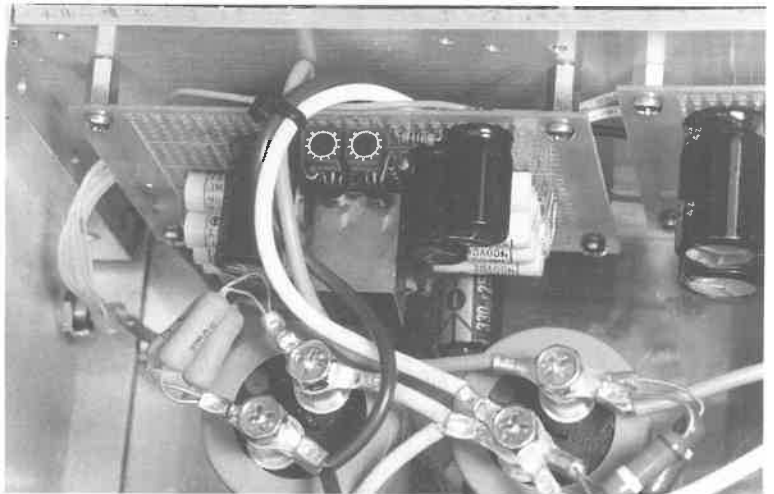
●電源部のクローズアップ
